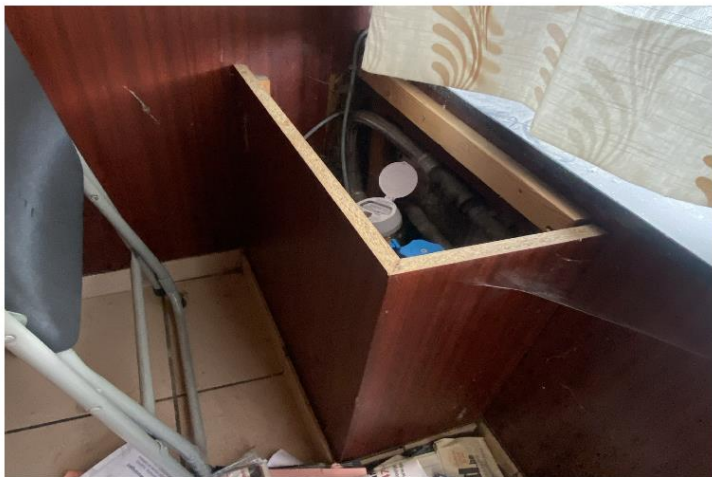
Gelijkvloers Aansluiting waterleiding
