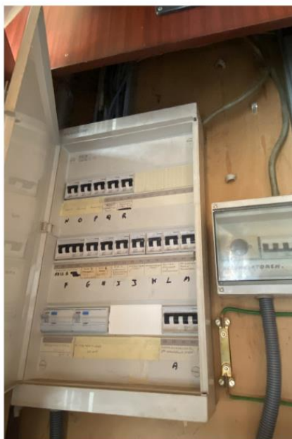
Gelijkvloers Zekeringkast (close-up)
