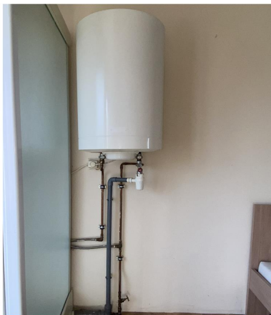
Tweede verdieping Boiler
